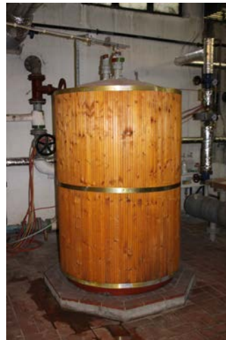
Stillgelegter Warmwasserspeicher (800 Liter) im Schulzentrum Sophie Scholl
