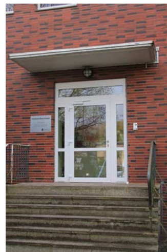
Neue Eingangstür in der Friedrich-Ebert-Schule Kunststoffrahmen mit Wärmeschutzverglasung
