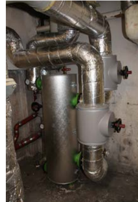
Neuer, effektiver Wärmetauscher im Verwaltungszentrum
