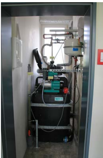
Erweiterung der Regenwassernutzungsanlage in der Goetheschule
